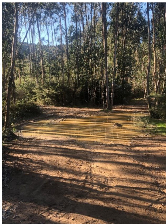
Fotografia 6.13 – Linha de escorrência com uma poça de água.
